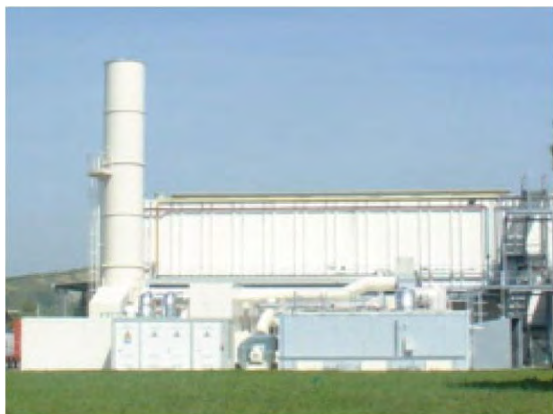
Sistema di abbattimento emissioni Reparto Verniciatura
