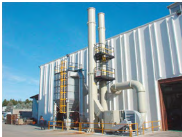
Sistema di abbattimento emissioni Reparto Pressofusione
