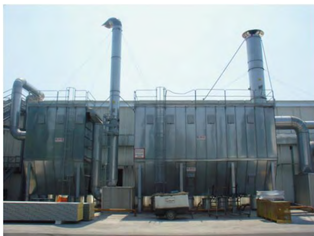
Sistema di abbattimento emissioni Reparto Saldatura
