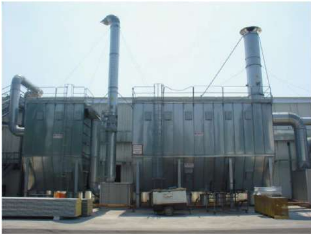
Sistema di abbattimento emissioni Reparto Saldatura
