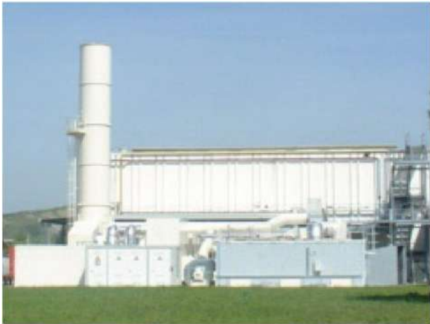
Sistema di abbattimento emissioni Reparto Verniciatura
