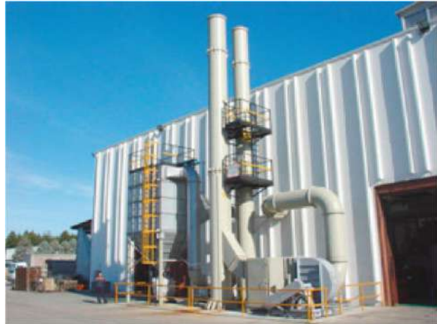
Sistema di abbattimento emissioni Reparto Pressofusione
