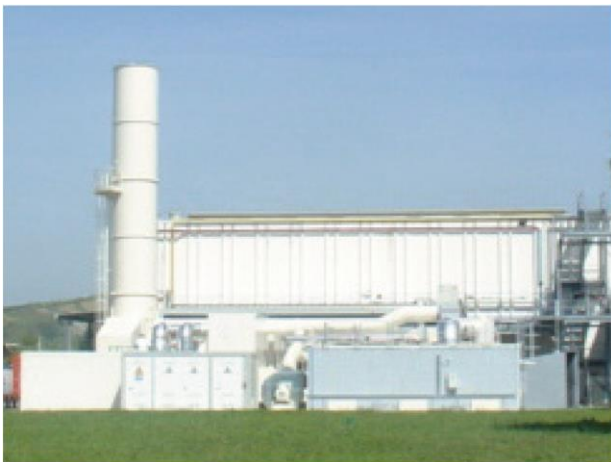
Sistema di abbattimento emissioni Reparto Verniciatura
