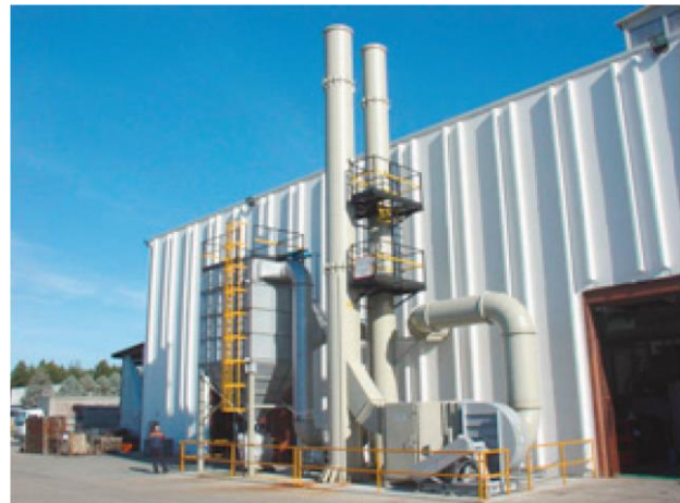
Sistema di abbattimento emissioni Reparto Pressofusione
