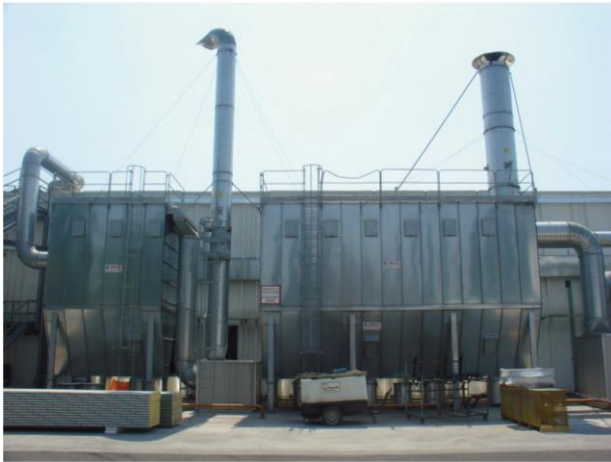
Sistema di abbattimento emissioni Reparto Saldatura
